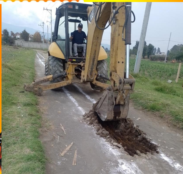
CONSTRUCCIÓN DE CALLE EN EL MUNICIPIO DE ATLAUTLA, LOCALIDAD SAN JUAN TEHUIXTITLÁN, CALLE NEXAPA.
